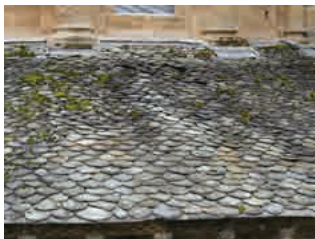
Faîtage du bras nord du transept incomplet, couverture du déambulatoire fuyarde, 2020. © M+O.
