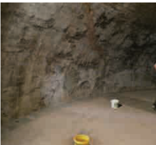
Fracture de la voûte et infiltrations au niveau de la galerie haute du déambulatoire, 2020. © M+O.
