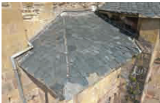
Joints ouverts, couvertures désorganisées, solins affaissés, 2020. © M+O / Drôme Aveyron Services.
