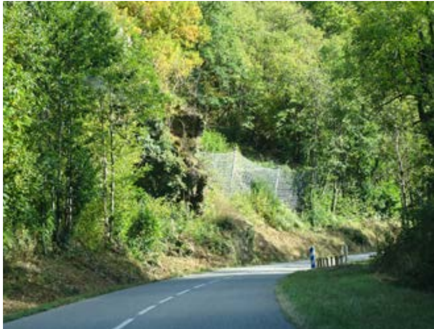
Filets métalliques de protection contre la chute des roches à mieux intégrer
