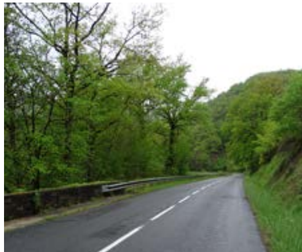
La glissière de sécurité prend le relais du muret introduisant un caractère routier banalisant.
